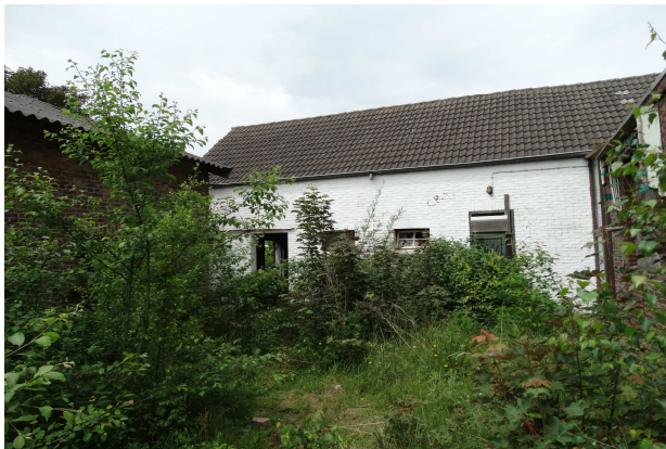
Figuur 7: Aanzicht een van de te slopen bijgebouwen. De achtertuin van de woning is sterk verwilderd door struiken en ruigtekruiden
