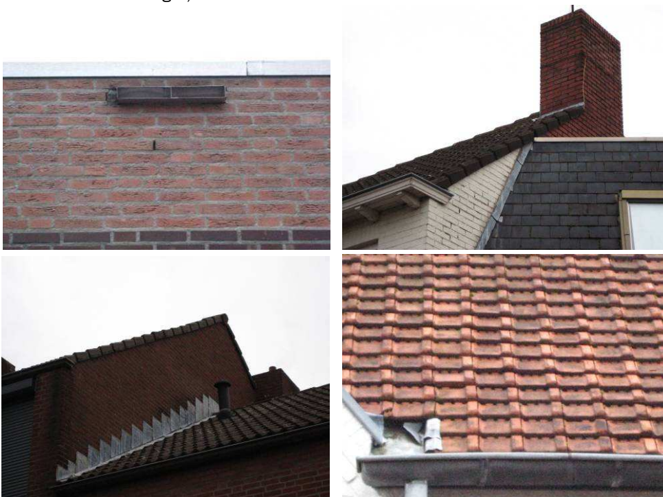
Foto 5.1 t/m 5.4: Spouwmuurgat, overhangende dakpannen en kieren en gaten in het dak van diverse gebouwen in het plangebied.
