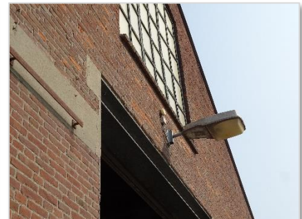
Foto 39: Pand 5 – kieren en openingen bij dakrand zuidzijde.
