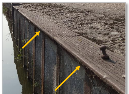
Foto 60: Kade aan Roode Vaart – regelmatig met gaten en openingen bij kade-rand.
