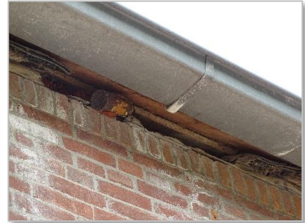
Foto 48: Pand 5 – kieren en openingen bij dakrand oostzijde.
