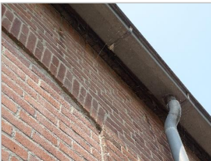
Foto 47: Pand 5 – kieren en openingen bij dakrand oostzijde.
