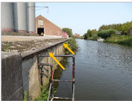
Foto 58: Kade aan Roode Vaart – regelmatig met gaten en openingen bij kade-rand.
