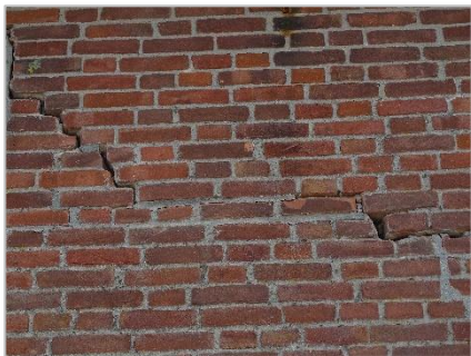
Foto 22: Pand 3 – huisje weegbrug scheuren in gevel.
