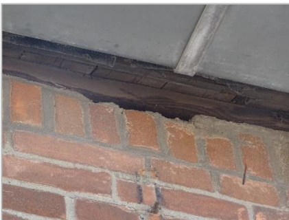
Foto 46: Pand 5 – kieren en openingen bij dakrand westzijde.
