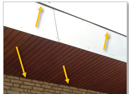
Foto 30: Pand 4 – kieren langs dakaansluiting gevel en dakrand.
