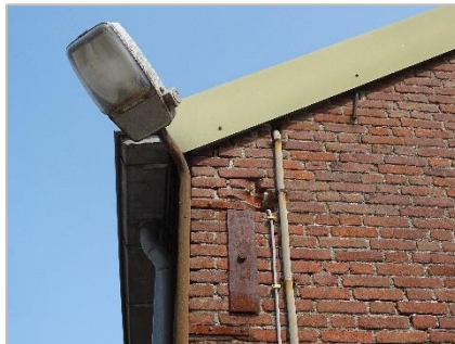
Foto 38: Pand 5 – kieren en openingen bij dakrand zuidzijde.
