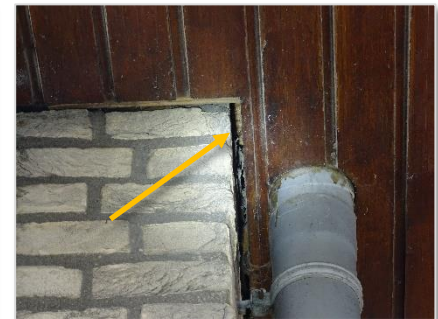
Foto 27: Pand 4 – kieren langs dakaansluiting gevel.
