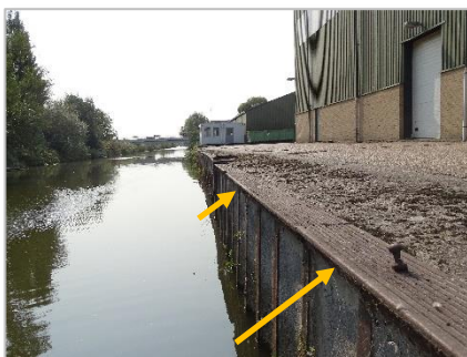
Foto 59: Kade aan Roode Vaart – regelmatig met gaten en openingen bij kade-rand.
