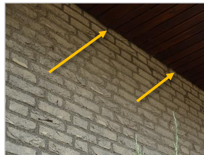
Foto 29: Pand 4 – kieren langs dakaansluiting gevel.
