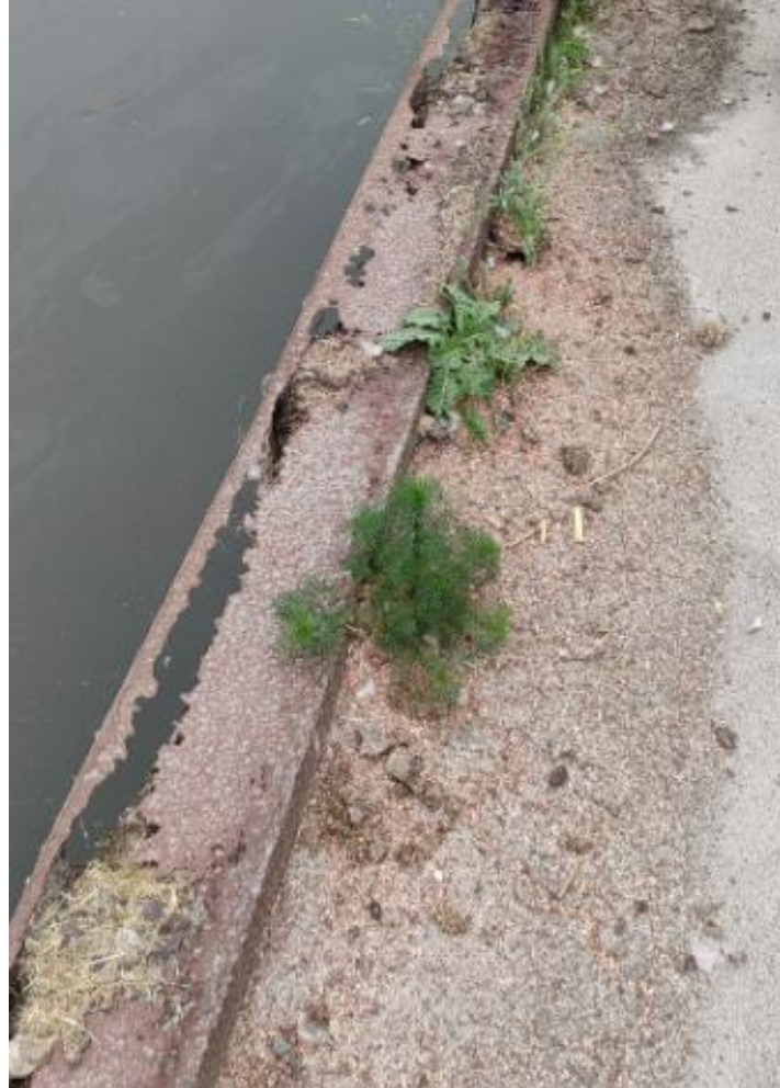
Foto 6: ernstige corrosie deksloof en stalen balken
