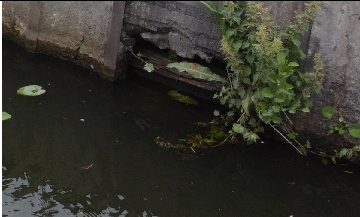
Foto 2: schade betonelementen t.h.v. waterlijn
