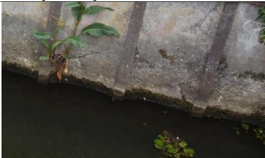
Foto 5: Ernstige scheurvorming betonelementen
