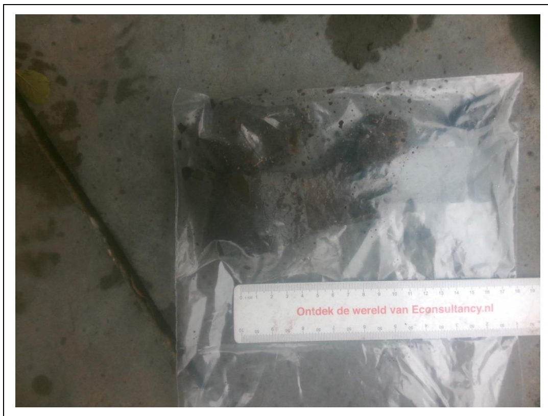
Foto asbestverdacht plaatmateriaal ASB-07.
