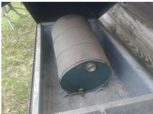
Afbeelding 3: brandstofvat 200 liter, geplaatst in een lekbak
