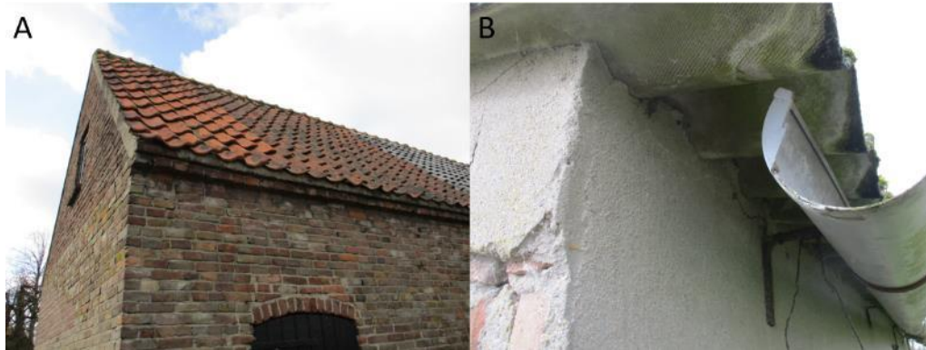
Figuur 2 A: Schuur aan de zuidzijde waarbij metselwerk de toegang naar de spouwmuur versperd, B: Stukwerk zorgt ervoor dat de schuur aan de noordzijde ontoegankelijk is voor vleermuizen.
