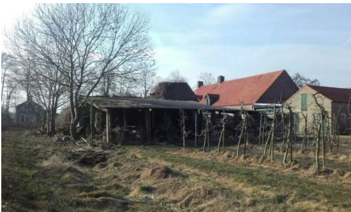
Figuur 16: Achterzijde vervallen schuur aan Nijmeegsestraat 48
