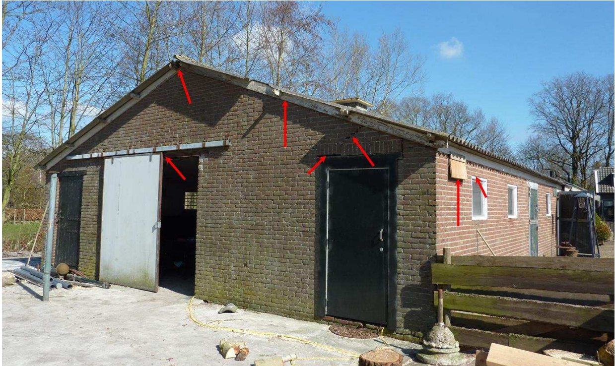
Figuur 3. Enkele voorbeelden van de vele mogelijkheden voor vleermuisverblijfplaatsen in schuur nr. 2.
