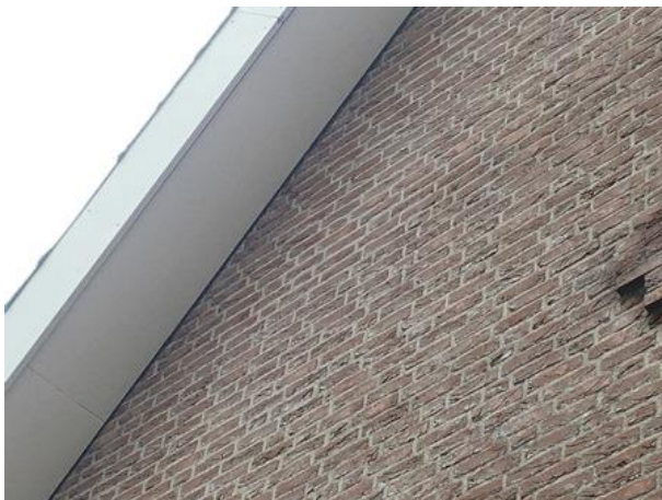
De kier tussen de betimmering van het overstek en de buitengevel bieden vleermuizen de kans een verblijfplaats te bezetten in de spouw en het dakvlak.
