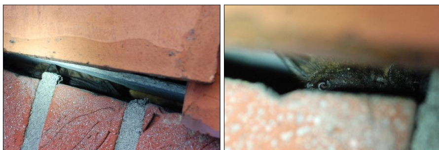
Laatvlieger onder overhangende gevelpan
