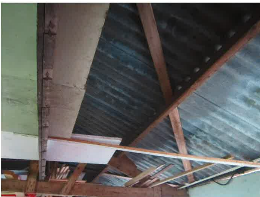
MM 2 Foto 10, Asbesthoudende golfplaten en hulpstukken op het dak van de schuur.
