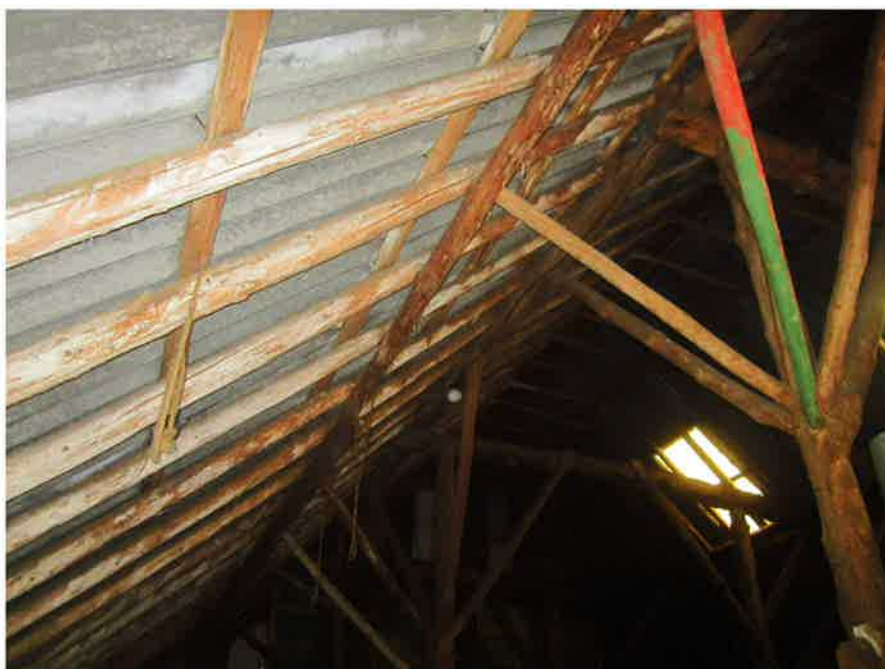
MM 1 Foto 6, Asbesthoudende golfplaten en hulpstukken op het dak van de boerderij.
