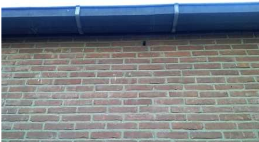
Open stootvoeg in buitenmuur; potentiële invliegopening voor vleermuizen.
