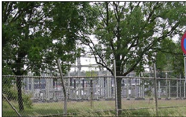
Afbeelding 9: Trafostation aan de Stichtsekade / Cannenburgerweg
