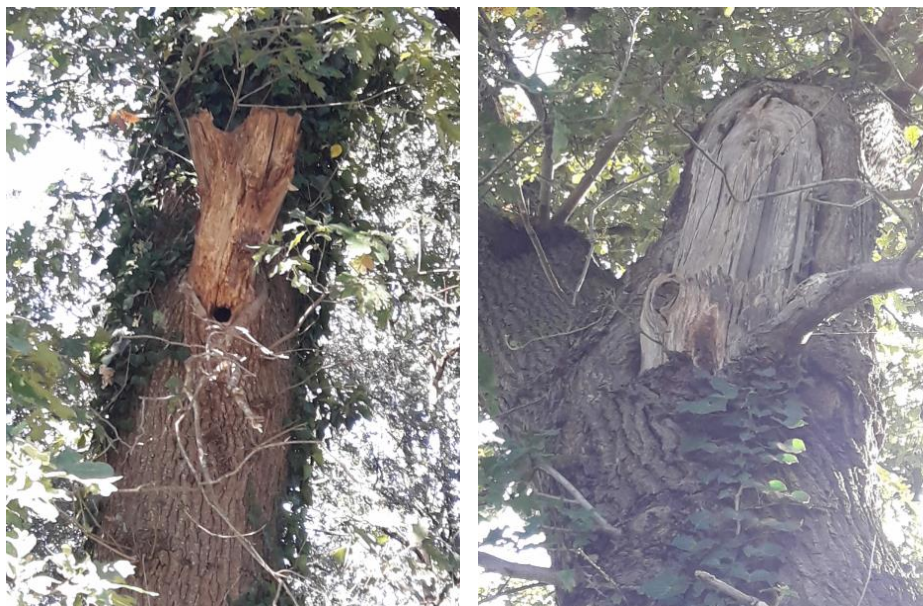
Foto2 en 3: mechanische gebreken
