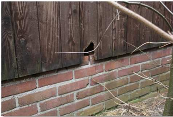
Vraatsporen aan de wand van de houten schuur; ratten of mogelijk steenmarter.
