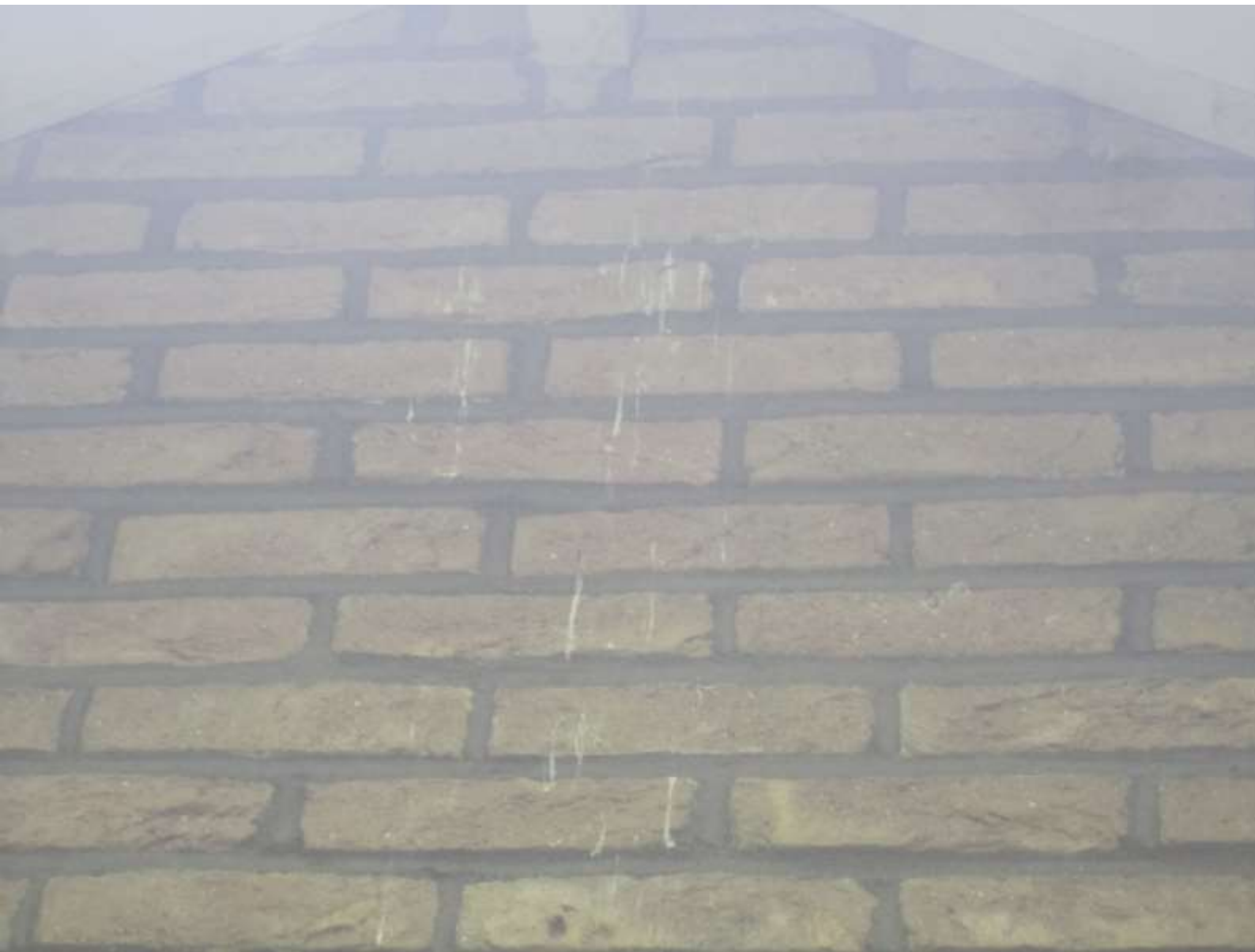
Foto 4. Poepsporen in de oost-noord-oostelijke nok van 't Stekkie.
