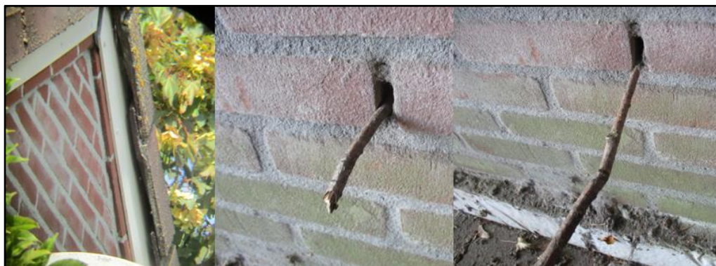
Figuur 3 Kierende kantpannen en open stootvoegen welke naar de luchtsponw leiden in het woonhuis en de schuur aan de Voederheil 16 te Zeeland.
