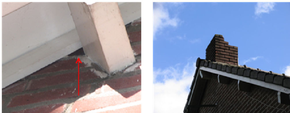
Afbeelding 3: Mogelijke verblijfplaatsen vleermuizen (foto's SAB, 2010).
