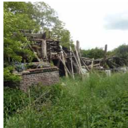
ingestorte schuur op het erf
