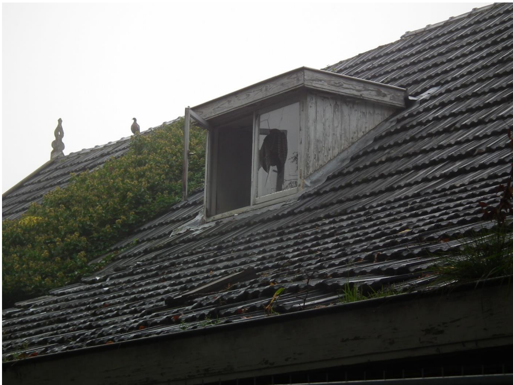
Figuur 2 Het woonwinkelpand is dermate vervallen dat een groot aantal dakpannen ontbreken, ramen zijn ingegooid en het dak en gevels begroeid zijn met klimop.
