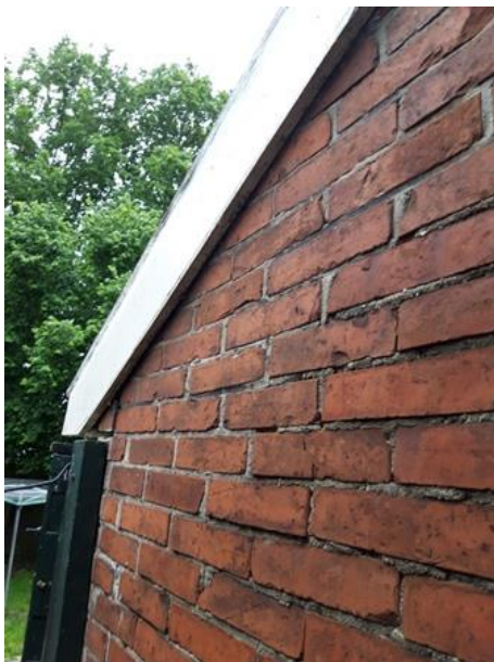
Gevelplank met een kier tussen de plank en de muur; vleermuizen bezetten geen verblijfplaats achter de gevelplanken in het plangebied.
