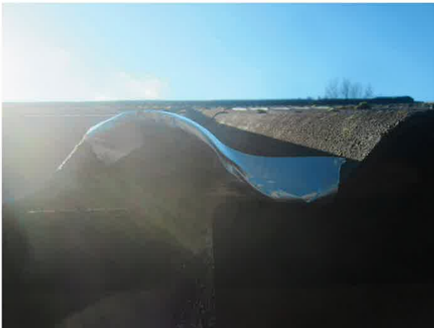
MM 1 Foto 2, Asbesthoudende golfplaten en hulpstukken op het dak van de stal, detailfoto monsternamelocatie.
