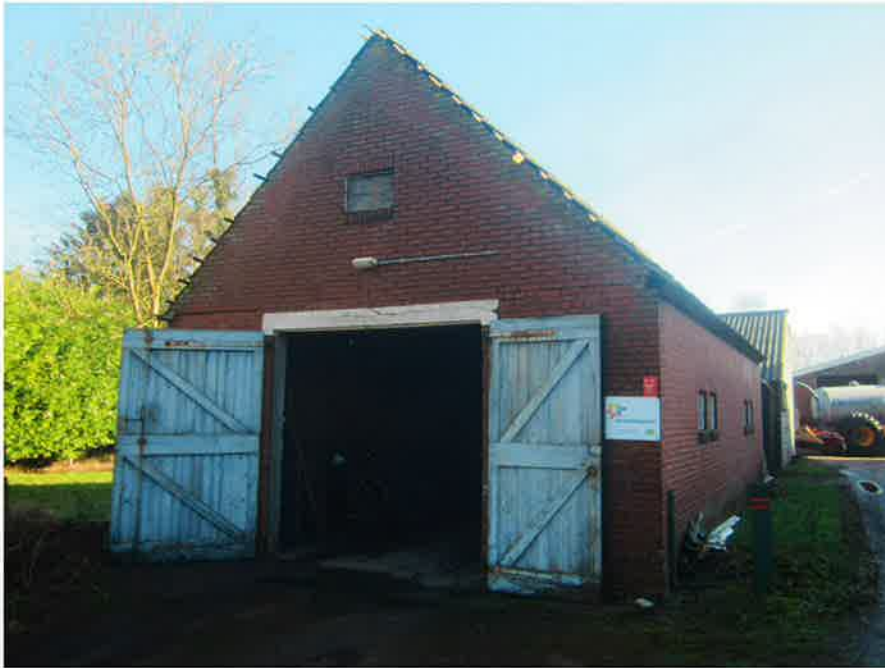
Foto 11, Overzichtsfoto van de buitenzijde van de asbestvrije schuur voor op het erf van de boerderij.
