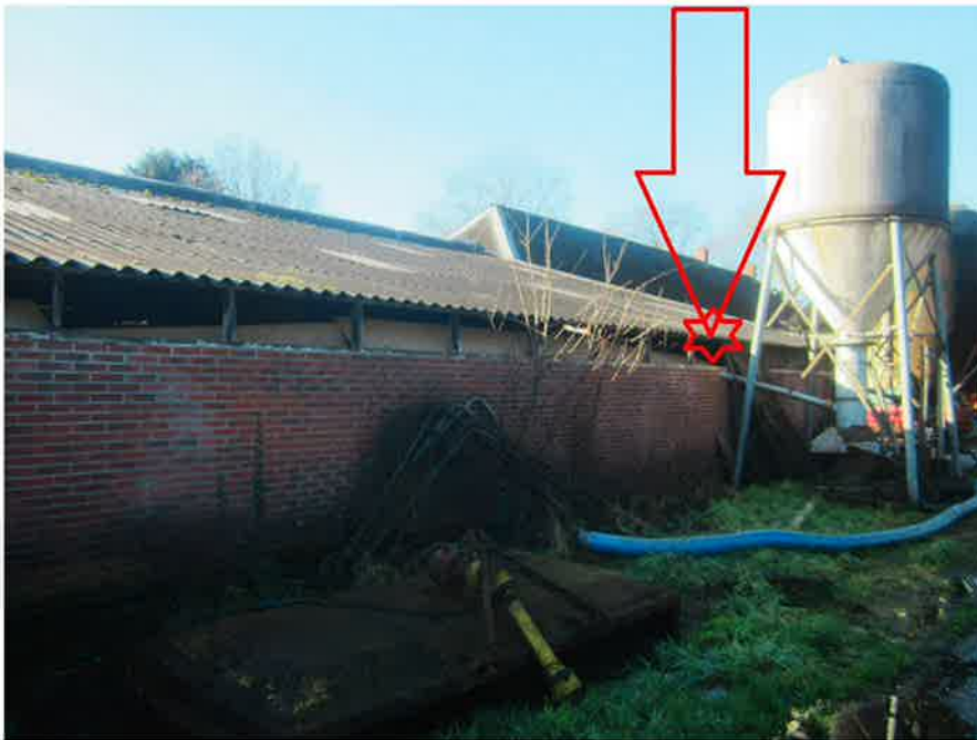
MM 1 Foto 1, Asbesthoudende golfplaten en hulpstukken op het dak van de stal, overzichtsfoto monsternamelocatie.
