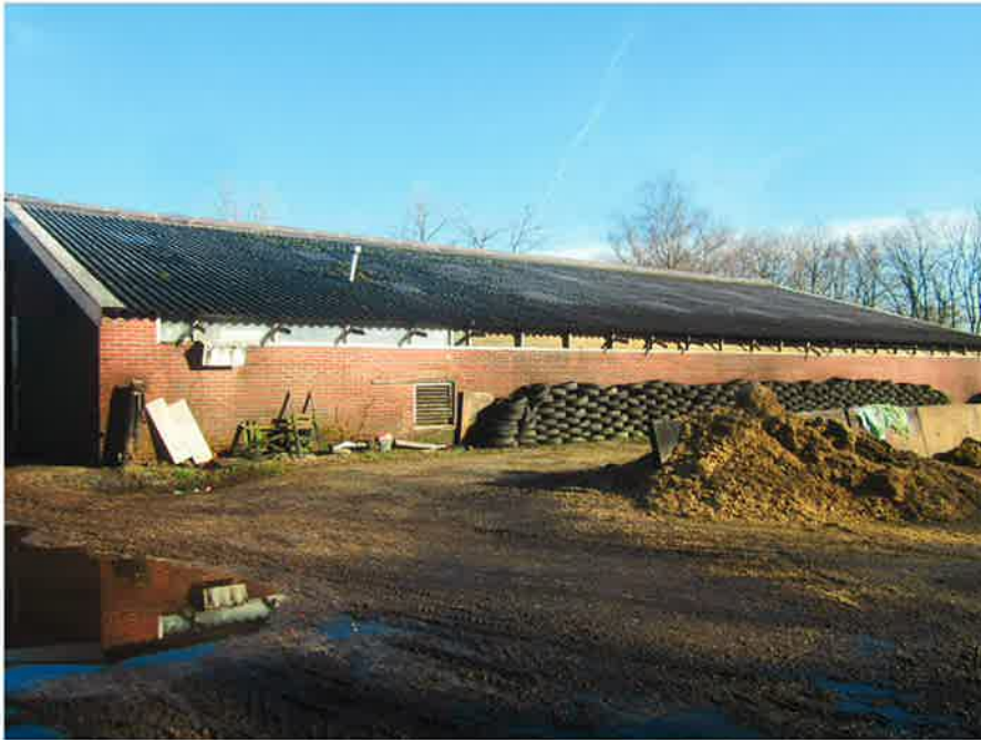
MM 1 Foto 3, Asbesthoudende golfplaten en hulpstukken op het dak van de stal.
