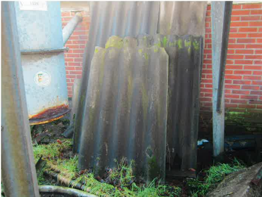
MM 1.1 Foto 10, Losstaande asbesthoudende golfplaten tegen de zijgevel van de stal.
