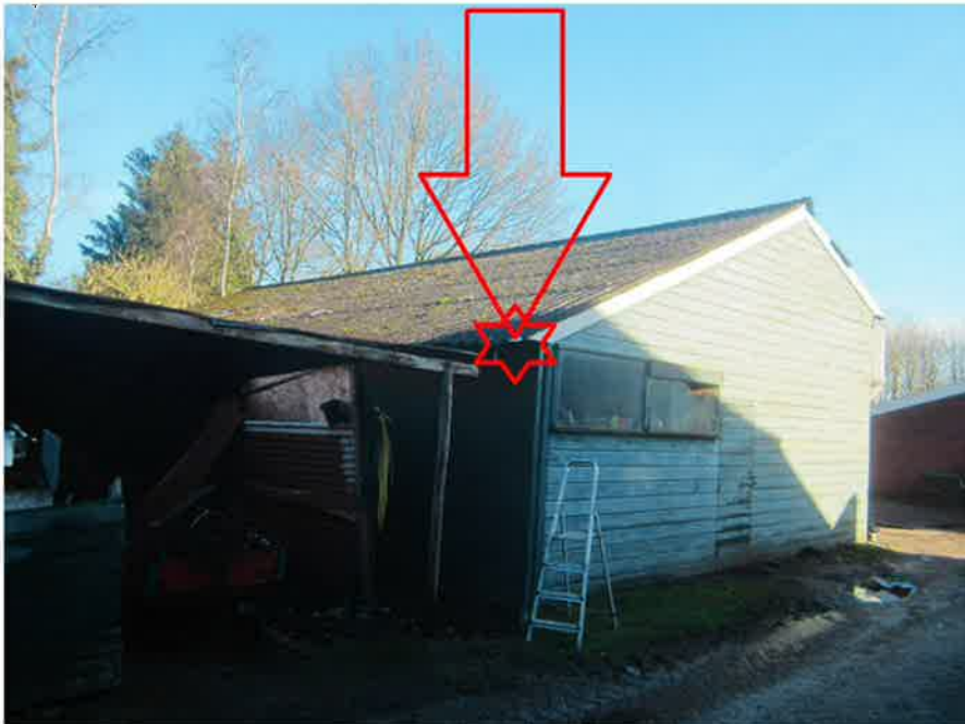
MM 2 Foto 6, Asbesthoudende golfplaten en hulpstukken op het dak van de kapschuur, overzichtsfoto monsternamelocatie.
