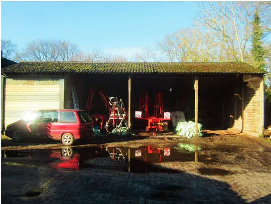
MM 2 Foto 8, Asbesthoudende golfplaten en hulpstukken op het dak van de kapschuur.
