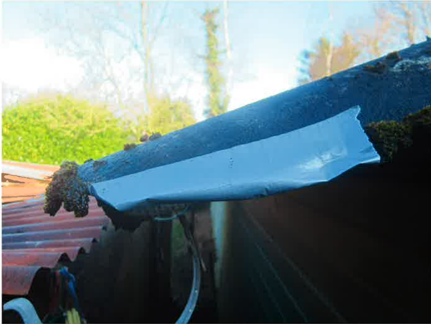
MM 2 Foto 7, Asbesthoudende golfplaten en hulpstukken op het dak van de kapschuur, detailfoto monsternamelocatie.
