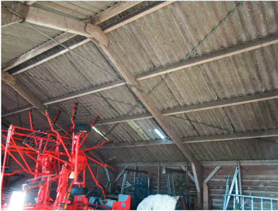
MM 2 Foto 9, Asbesthoudende golfplaten en hulpstukken op het dak van de kapschuur.
