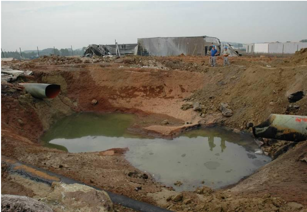
Figuur 3: Krater van ontploffing in België veroorzaakt door graafwerkzaamheden
