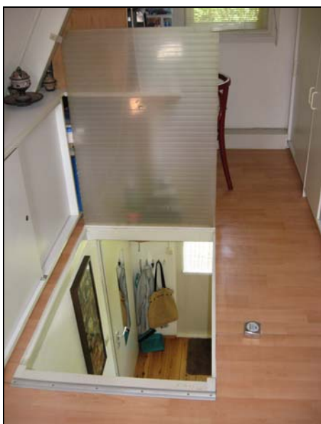
Balustrade en trapleuning niet aanwezig.
