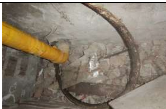
Geen koord bij gasdoorvoer
