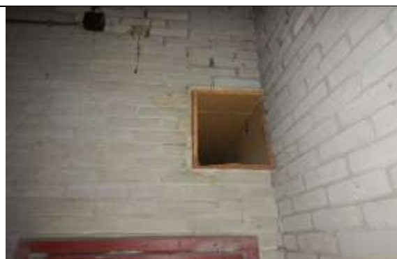
Ventilatiekanaal van hout
