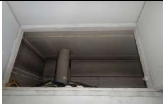
Onluchtingskanalen van pvc
