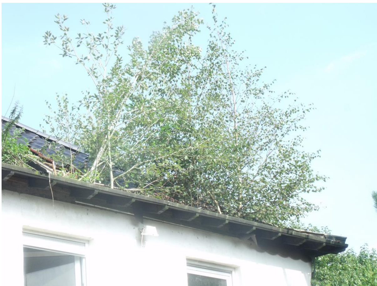
In de dakgoot groeien berken en brandnetels
