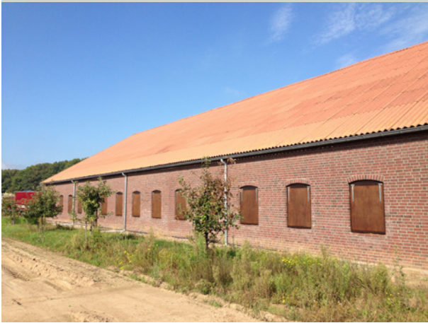
Zuidzijde van de loods, passend in de stijl bij de oude hoeve.
