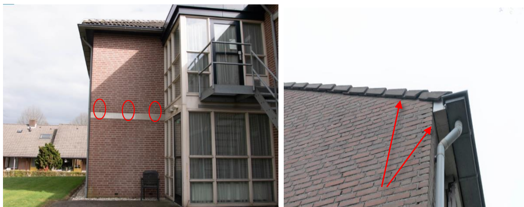
Spouwgaten en kieren die geschikte toegang tot verblijfplaatsen bieden voor gebouwbewonende vleermuizen (foto's Laneco).
