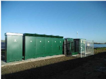
Referentiebeeld - v.r.n.l. Omvormer, Transformator en Switchgear
