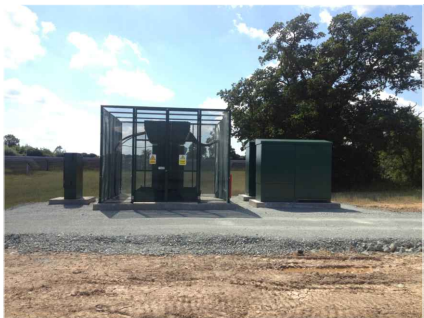
Referentiebeeld - v.r.n.l. Omvormer, Transformator en Switchgear
