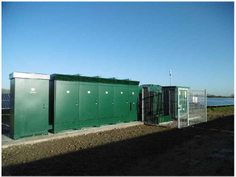
Referentiebeeld - v.l.n.r. Omvormer, Transformator en Switchgear
