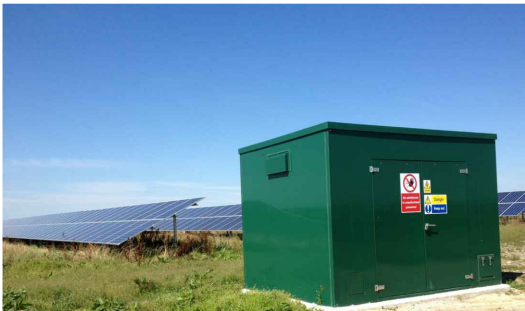
Referentiebeeld - Klant onderstation
