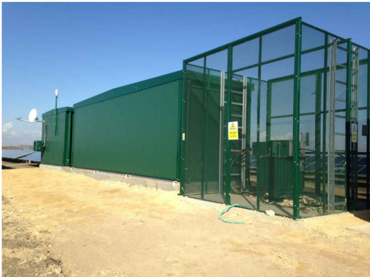
Referentiebeeld - v.l.n.r. Monitoring Station, Klant Onderstation, Aux. Transformer
