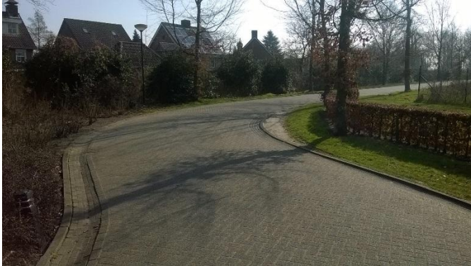
Bermschade in binnenbocht Brugstraat
