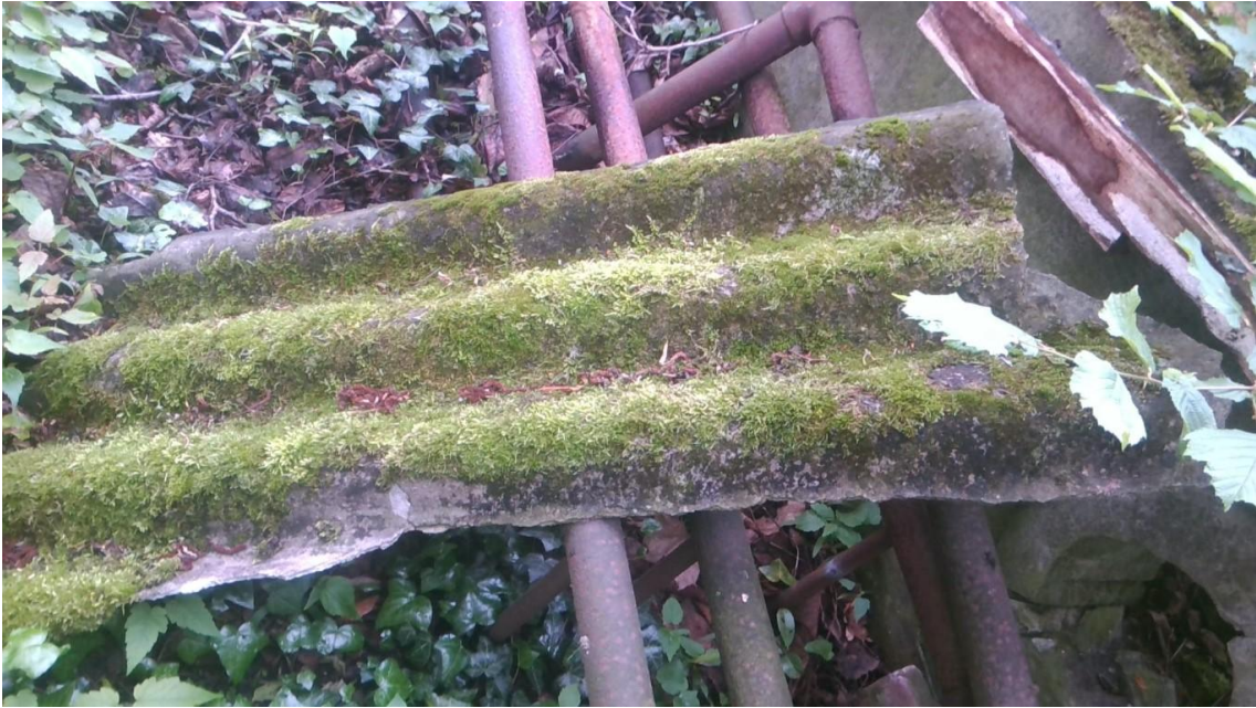
Afbeelding 7: (waarschijnlijk asbesthoudende) golfplaat
