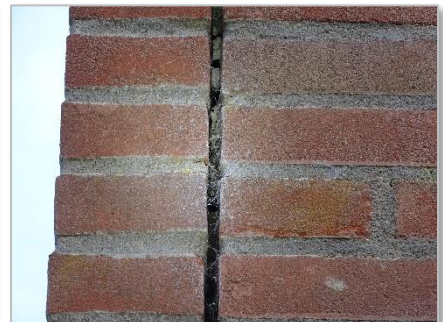
Foto 33: Stootvoegen gevels voormalige drukkerij (te smal voor toegang vlermuizen – let op spinrag in stootvoeg).
