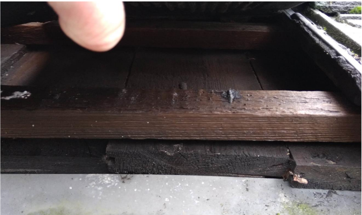
Figuur 4.5.1. Onder de onderste rij dakpannen op het schoolgebouw is geen ruimte voor huismusnesten; de ruimte onder de dakpannen wordt versperd door een panlat.
