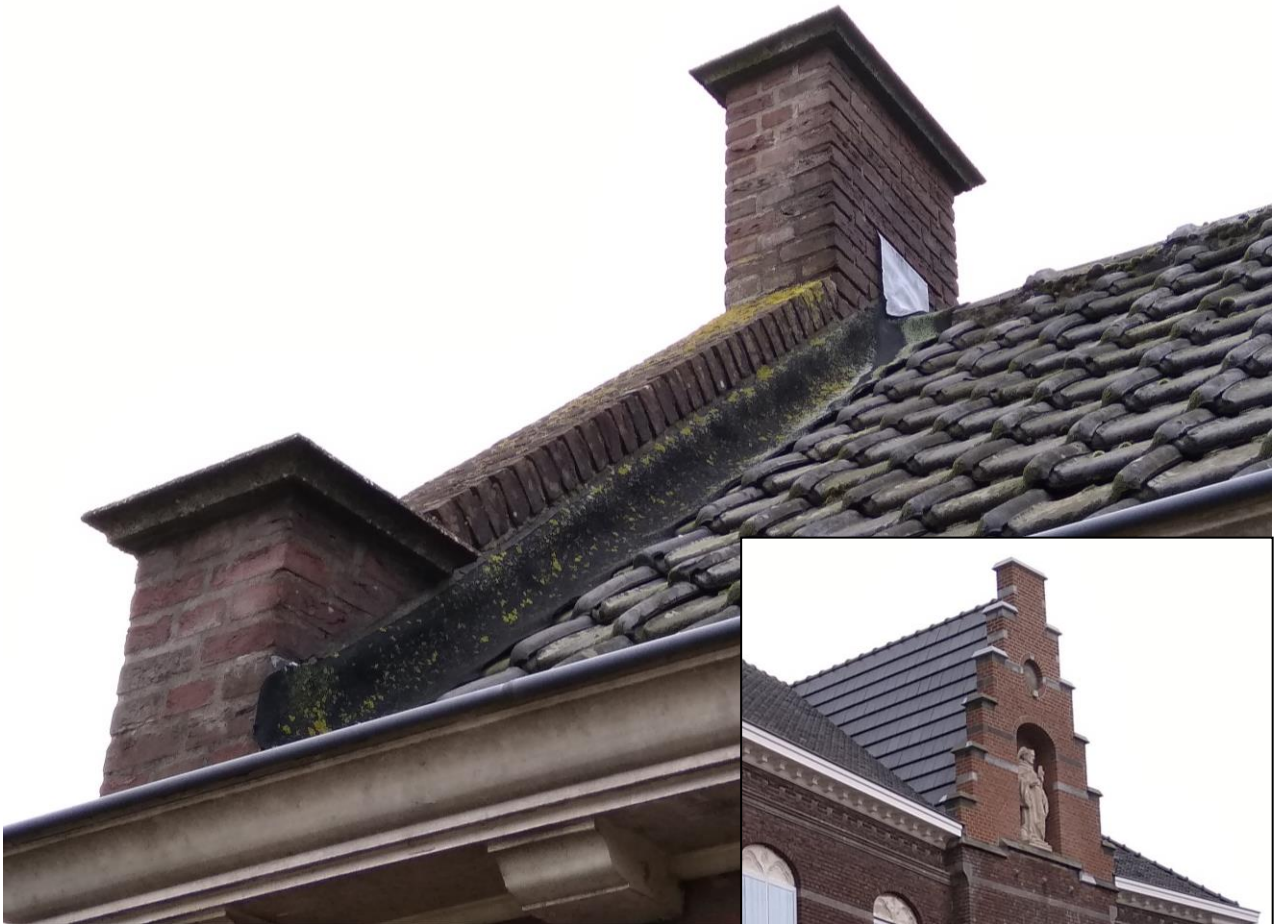
Figuur 4.5.2. Door de dakgootbetimmering en de hoog opgemetselde gevels is zowel het klooster (inzet) als de school niet toegankelijk voor gierzwaluwen.
