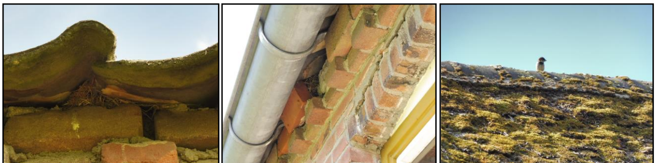
Figuur 2. Aangetroffen huismussennesten onder het te renoveren dak van de boerderij en mannetje huismus op het dak.
