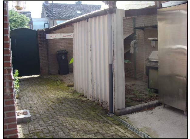
Foto 2. Te slopen opslagruimte/overkapping
