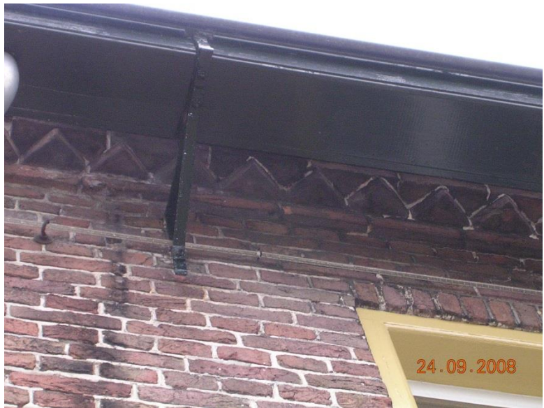
muizentand ter hoogte van de bakgoot voorgevel Keuken in aanbouw lange gevel noord.
