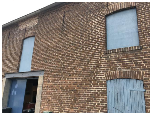
Voorgevel met centrale (geopende) toegangsdeur en dichtgetimmerde raamwerken
