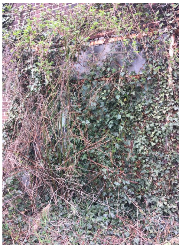
Stalen deur in linker zijgevel, aan de binnenzijde dichtgezet, overgroeid aan de buitenzijde
