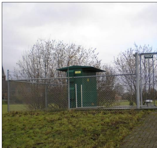
rioolgemaal met geurcontour (Oosderweg)
