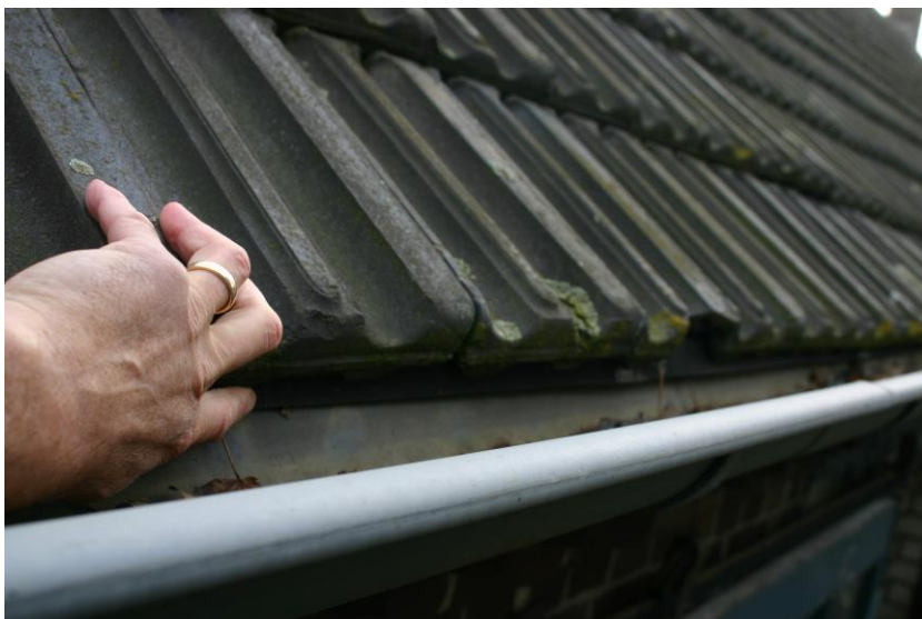
Figuur 4.2.1. Onder de onderste rij dakpannen op de langgevelboerderij is te weinig ruimte om vogels toegang te geven tot het dak.
