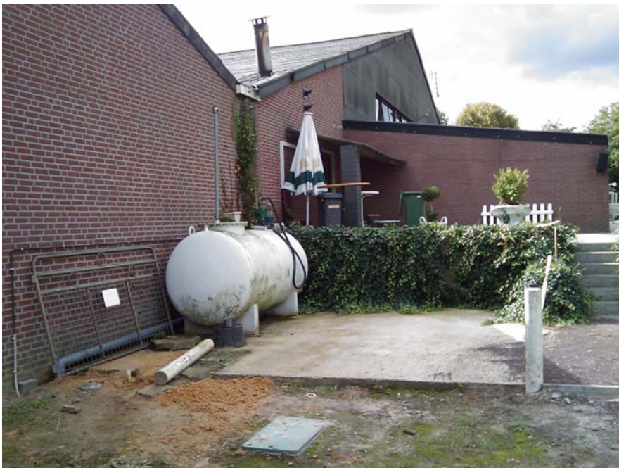
Foto bovengrondse dieselolietank
