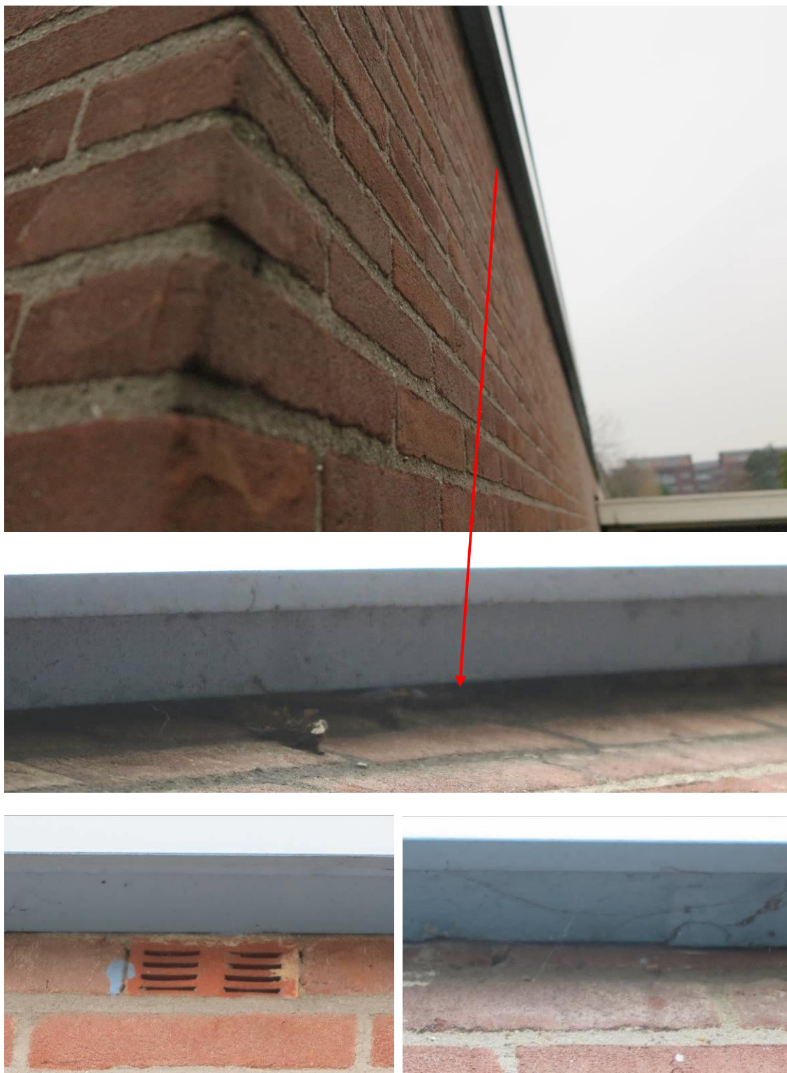
Figuur 3. Daklijst met spinnenrag en dichte beluchtigsgaten aan de Notaris Kruytstraat te Bergschenhoek.
