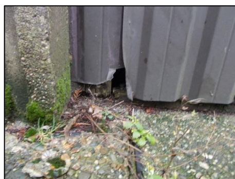
Figuur 13: Een gat in de muur van de schuur in gebouw 2. Bron: NWC
