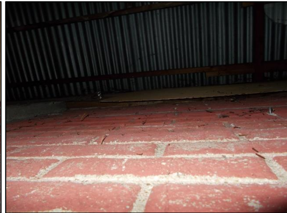
Figuur 11: Detailfoto van de onderkant van de houten panelen in de schuur in gebouw 2. Bron: NWC
