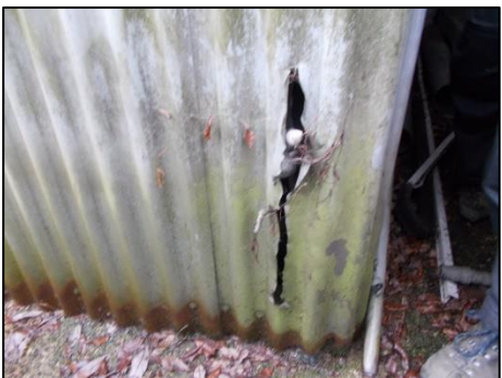
Figuur 14: Een gat in de muur van de schuur in gebouw 2. Bron: NWC
