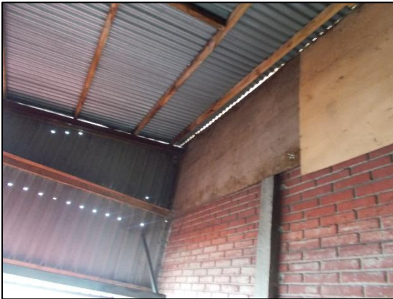
Figuur 10: Binnenkant van de schuur in gebouw 2. Er zijn openingen bij het dak te zien. Ook zijn er houten panelen bevestigd op de muur. Bron: NWC
