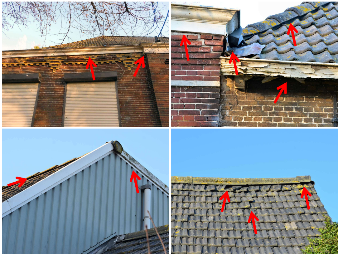
Figuur 9. Kieren en losse dakpannen bieden toegang tot mogelijke verblijfplaatsen voor vleermuizen.
