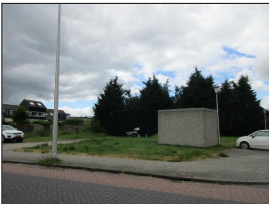
Foto 3: Elektriciteitsgebouwtje en trottoir
