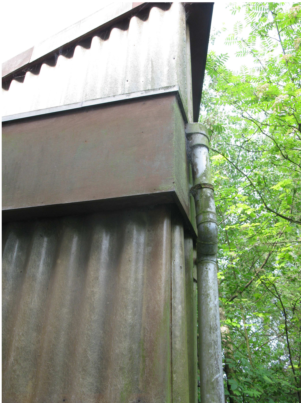
Foto 1: openingen tussen de beplating en wanden
