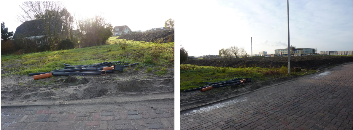
Figuur 2.2: Locatiebezoek 8 en 9 december 2014; Veilingweg 84 met rondom sloten en de opgebrachte voorbelasting (circa 1,5 meter) ten westen van Veilingweg 84.
