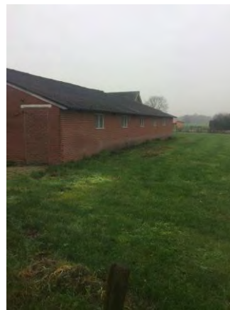
Figuur 9: Ontbreken van dakgoot bebouwing
